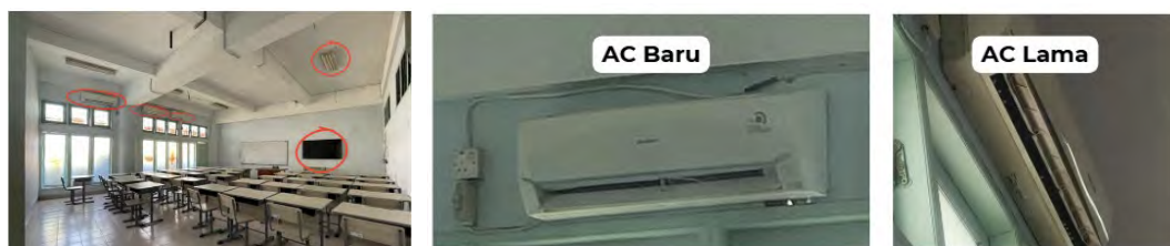
Gambar 4. Penggunaan air conditioner pada bangunan Sumber: Dokumentasi pribadi
